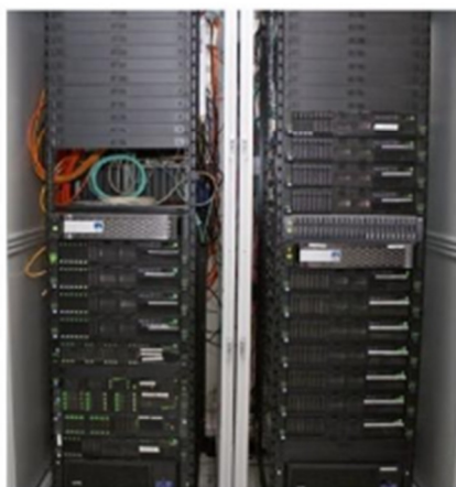
Am Stammsitz in Heilbronn wurde ein Rechenzentrum mit Terminallösung geschaffen
